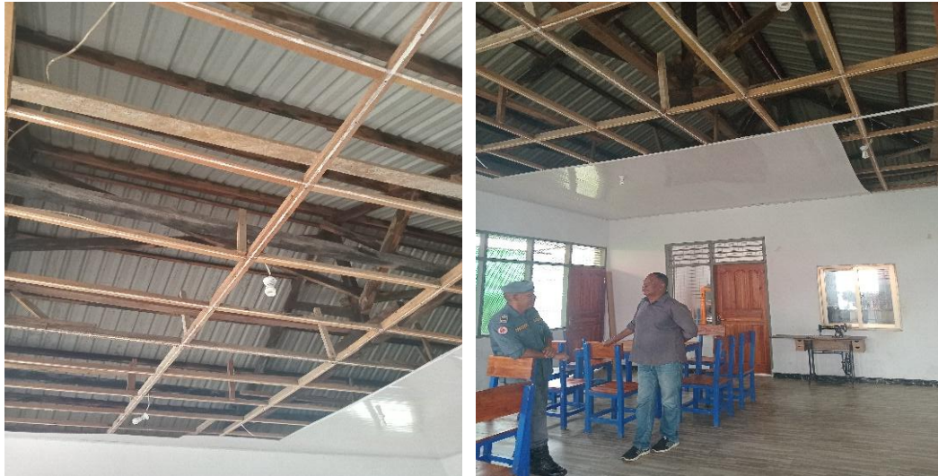
Foto 21: Rezultadu monitorizasaun tinan 2025, Plafon Bloku A. (foto) Prizaun Gleno ne'ebé monu ne'ebé seidauk hetan manutensaun
